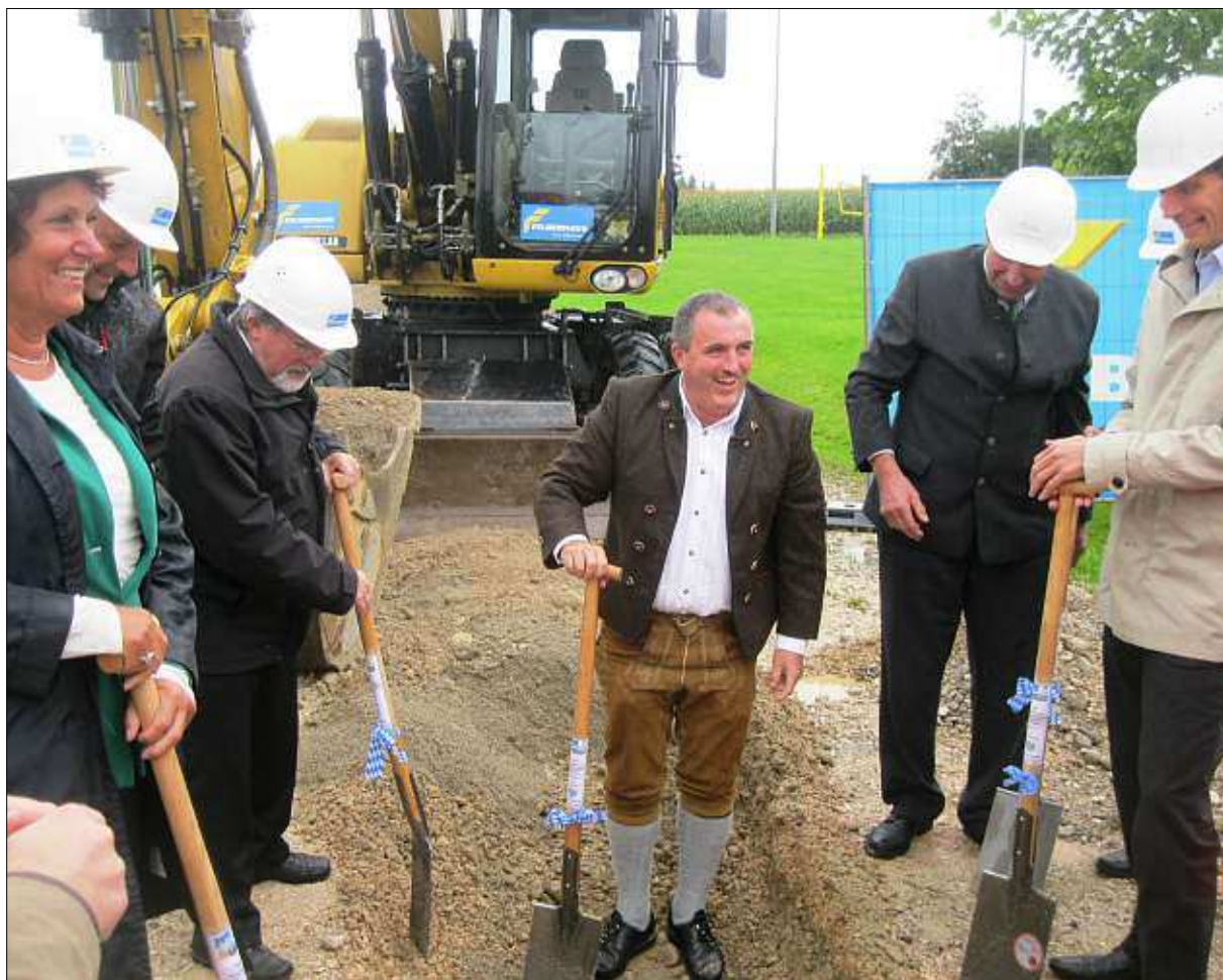
Freuten sich über den Spatenstich für das Großprojekt „Fernwärmenetz“ in der Gemeinde Kirchweidach (von links): MdL Ingrid Heckner, der Bauamtsleiter der Verwaltungsgemeinschaft Reiner Hundsberger, stellvertretender Landrat Stefan Jetz, der Geschäftsführer der Kirchweidacher Energie GmbH Marcus Hansen, Bürgermeister Johann Krumbachner und Jens Kötting vom zuständigen Planungsbüro. – Foto: Heckmann
